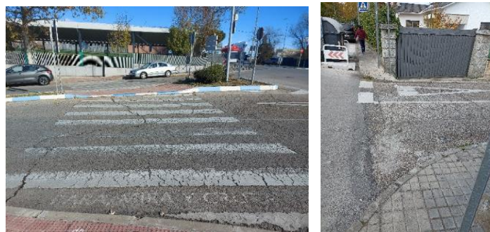
Ilustración 28 Ejemplos deterioro pavimento itinerarios peatonales
